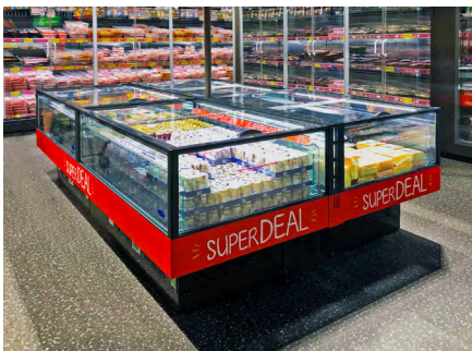
Marktinstallation. EasyCube-Kühler in Blockinstallation mit Spaltabdeckungen.
