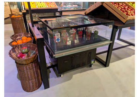
Marktinstallation. Die geschlossenen Versionen bieten nicht nur eine bessere Energieeffizienz, sondern auch eine bessere Temperaturklasse für mehr Flexibilität.
